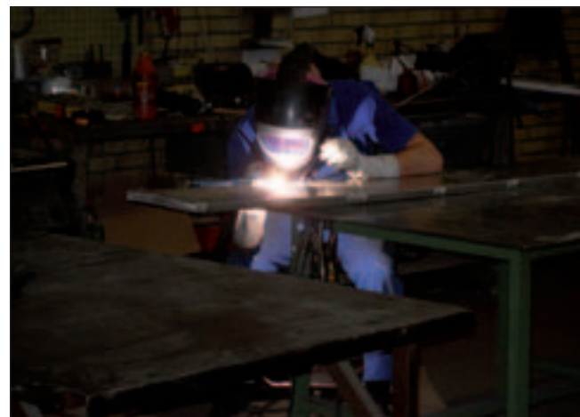
Ved håndsvejsning udgør lønnen ofte mere end 80 procent af de samlede svejseomkostninger, mens omkostningerne til svejsegas oftest udgør seks procent. Her håndsvejses hos Brdr. Larsen i Lynge.
